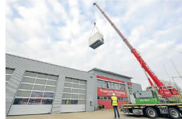
Die Stadt hat kürzlich drei Feuerwehrhäuser mit Notstromaggregaten ausgestattet. Sie garantieren im für jeweils drei Tage Ernstfall volle Einsatzfähigkeit. (Foto Rothe)
